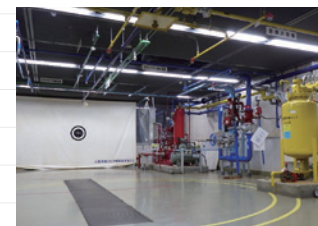
7 消火設備実習室 建築物に設置されている屋内消火栓やスプリンクラーなどの模擬設備を活用して、使用方法や仕組みを学びます。
